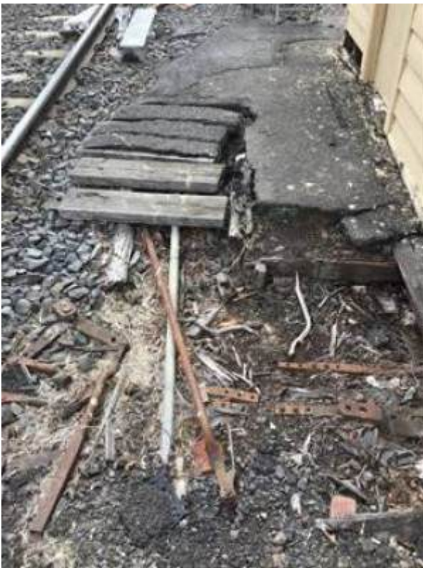
remnant interlocking equip signal box.jpg
